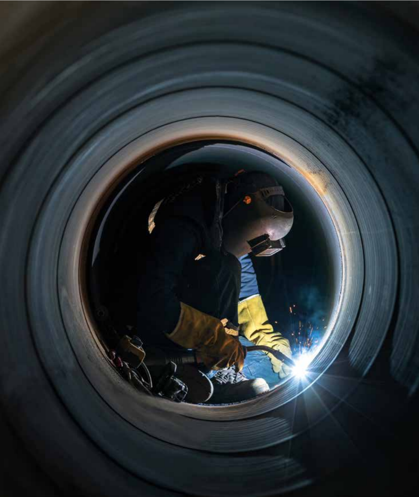
Soldadura de la cara posterior de una junta con garganta en V utilizando ROBOFIL M 71.
