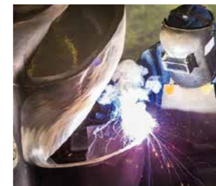
CHROME CORE B 13 4-G, riparazione di hydro Pelton Bucket
